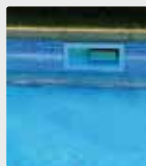
Ligne d'une piscine
