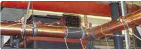
Vulcan S250 installé à l'hôpital St. Joseph
