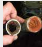
Sistema de tuberías
