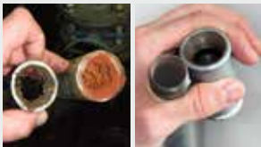
Sistema de tuberías
