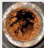
Biofilme em uma tubulação
