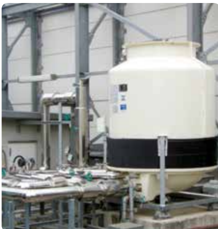
Tour de refroidissement
